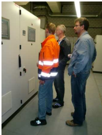
Die komplexe Infrastruktur im Tunnel
