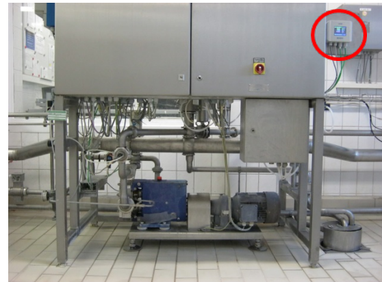
Bild 2: Beispiel einer Anstellregelung. Die beiden TurbiGuard sind hier nicht sichtbar, jedoch die Bedieneinheit SICON M (Kreis)
