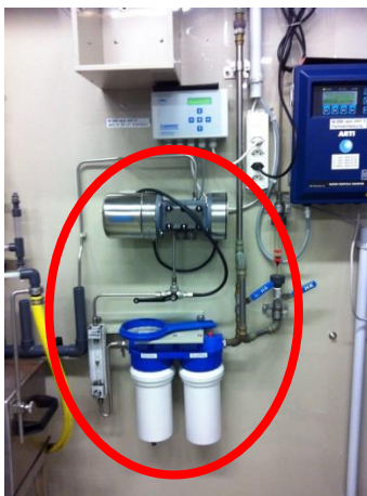
Bild 5: ColorPlus Bypass in Rohwasser mit Probenfiltration
