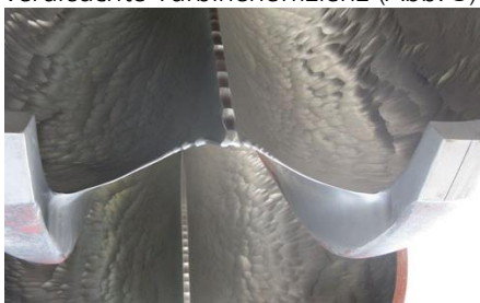
Abb. 2: Abrieb an einer Pelton-Turbine
