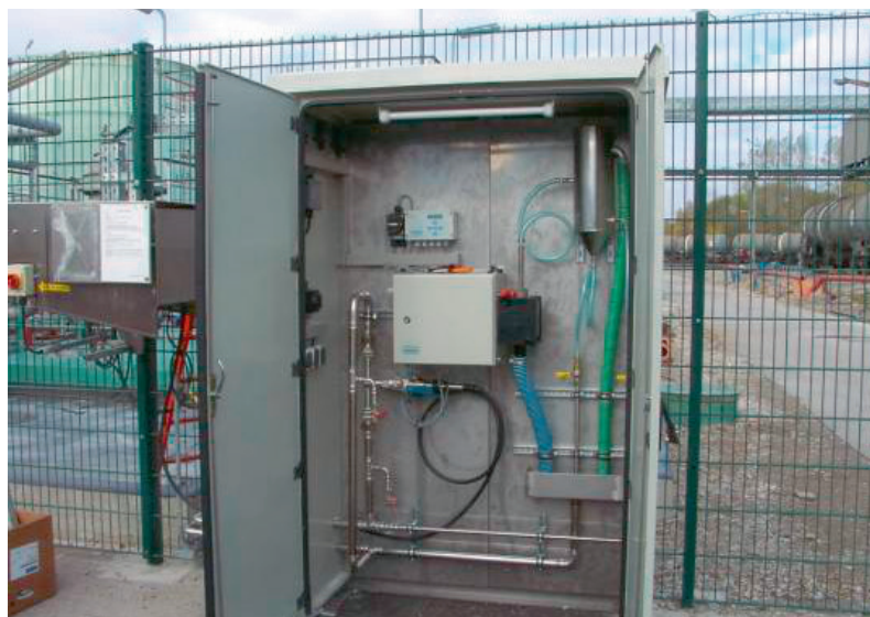
Ölspurenüberwachung des gesammelten Abwassers eines Tank- und Treibstofflagers
