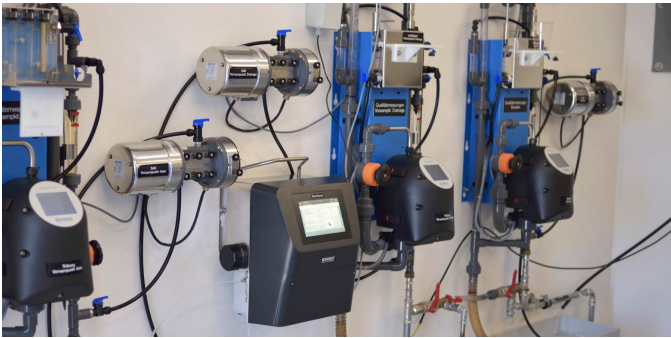
Bild 3: Montierter BactoSense in einer Grundwasserfassung
