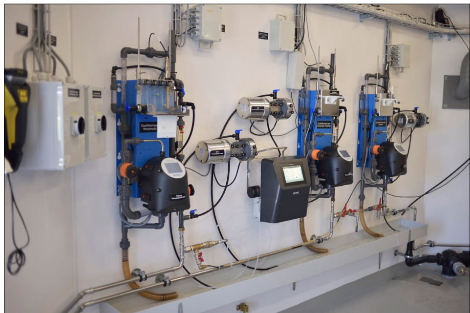
Bild 2: Montierter BactoSense in einer Grundwasserfassung
