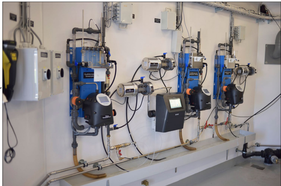
Figure 2: BactoSense installé dans un captage d'eau souterraine
