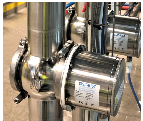
Bild 2: Umpumpleitungen mit eingebauten TurbiGuard
